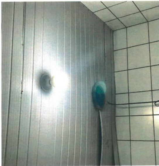
VENTILAÇÃO MECANICA WC INOPERANTE
