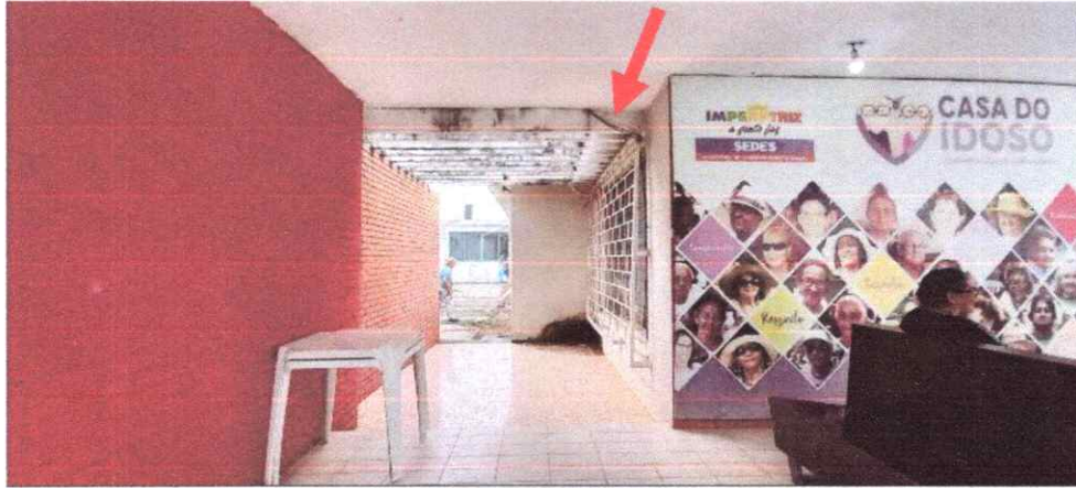
Foto 3 –Vista interna varanda. Isolar fiação em contato com grade metálica da janela.
