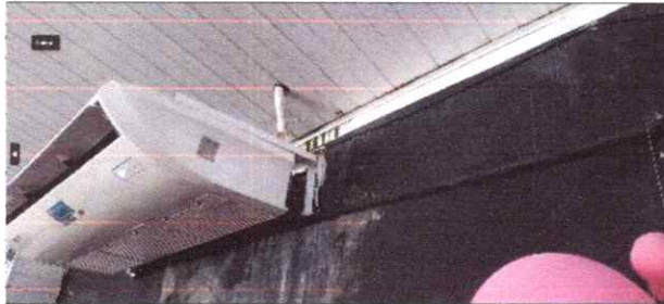
Foto 9 –Vista auditório. Retirar infiltração de água pluvial.
